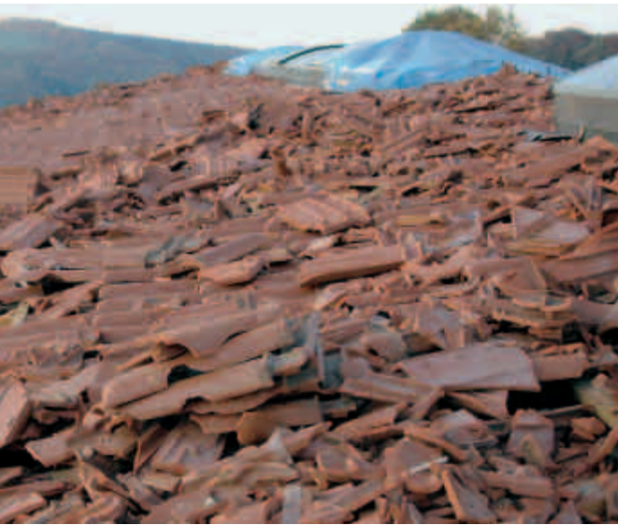
Ein Tornado beschädigte am 22. 10.2005 das Dach einer Lagerhalle in Motten (Quelle: B. Stumpf, Fulda).
