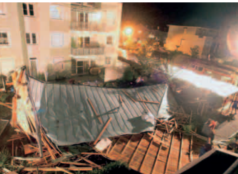
In der Nacht auf den 28.07.2005 ließen die Sturmböen eines Unwetters das Flachdach eines Mehrfamilienhauses in Frankfurt/Main herabstürzen (Quelle: ddp).
